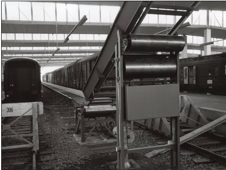
Bild 18: Postbahnhof Paket-Förderband zwischen Entladegleis 306 u. 305, mit Steigeband als Zuführung zum Pakum (Foto K. Tasche)
