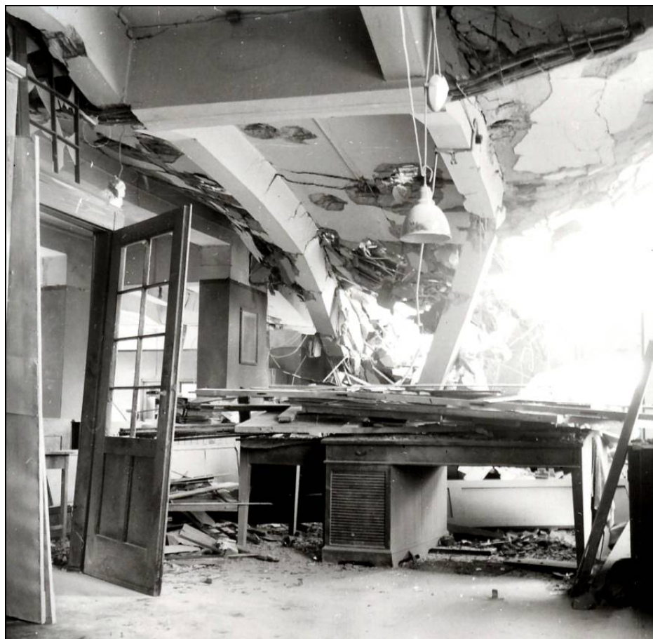
Bild 23: Ein durch Bombentreffer zerstörter Büroraum (Bild 22 u. 23 Archiv Westermann)
